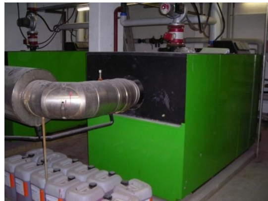
Chaudières de secours
