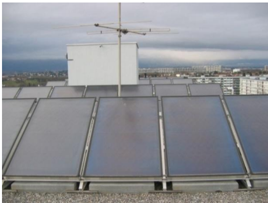
Capteurs solaires thermiques
