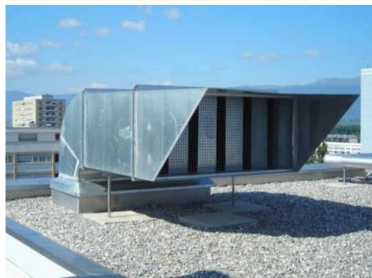
Air évacué du monobloc en toiture
