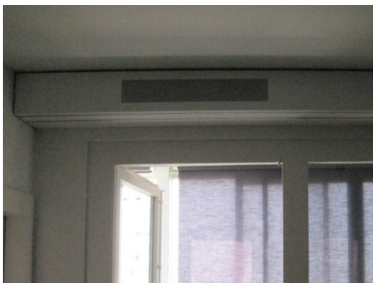
Caissons de pulsion dans les pièces
