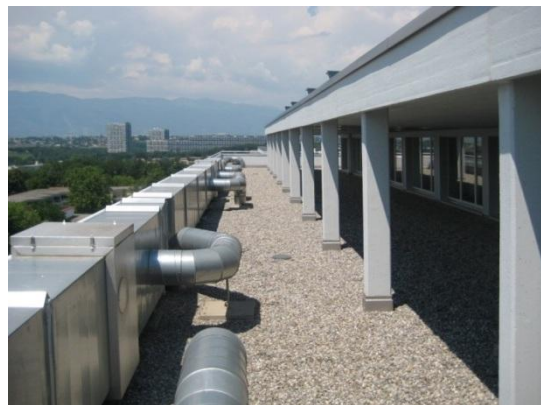
Gaine de pulsion d'air
